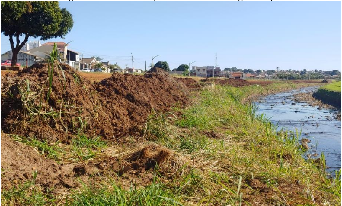
Figura 7.9 – Movimentação de talude no Córrego do Sapo.
